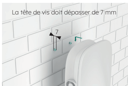
Figure 16. Accrochage de la station de recharge
